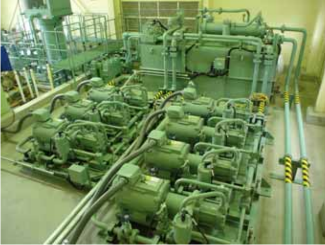
図 11 油圧装置全景
